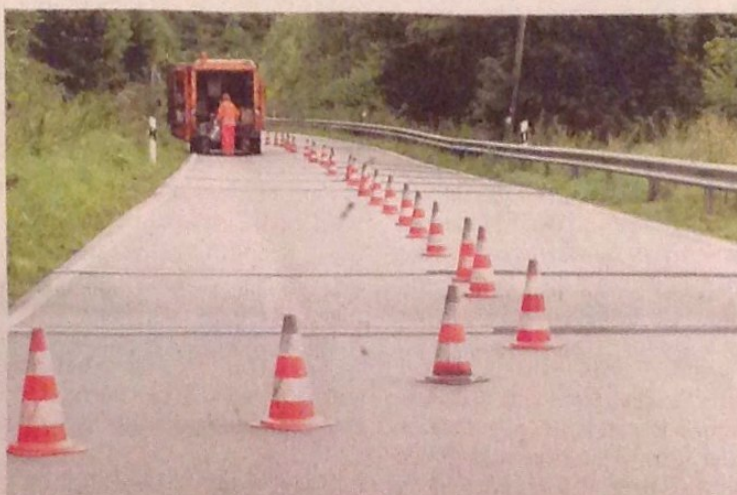
Auf der Olper Seite des Hohen Lenscheids wurden in der vergangenen Woche Rüttelstreifen vor den Kurven eingerichtet.
